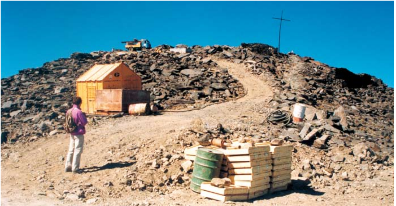
Obras para construcción de un radar militar en la cumbre del Mulhacén. Archivo FAM.
